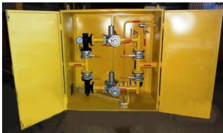
Рисунок 1.2 – Загальний вигляд контейнера газорегулюючої установки
