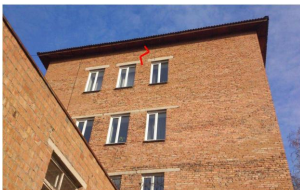
Рисунок 2.2 — Західний фасад будівлі із зазначенням місць розташування тріщин (виділено червоним)
