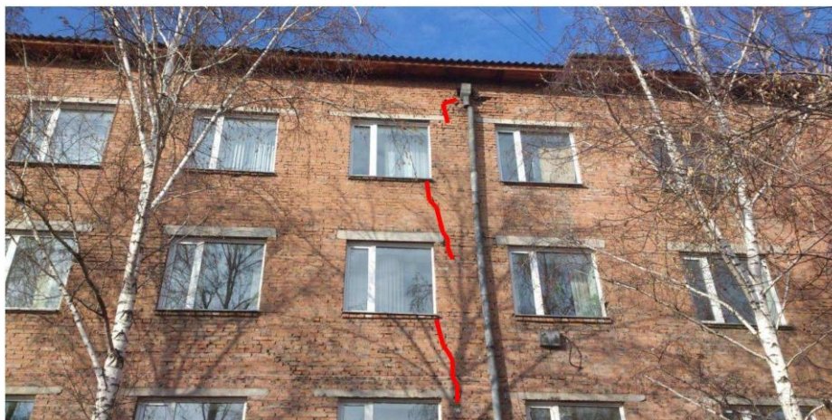
Рисунок 2.3 — Південний фасад будівлі із зазначенням місць розташування тріщин (виділено червоним)
