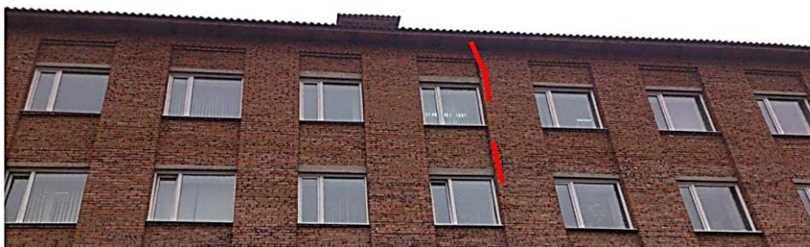
Рисунок 2.1 — Північний фасад будівлі із зазначенням місць розташування тріщин (виділено червоним)
