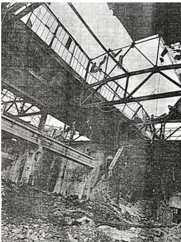
Рисунок 1.6 - Загальний вид руйнування прольотів «Є» - «Ж» та «Ж» - «З»
