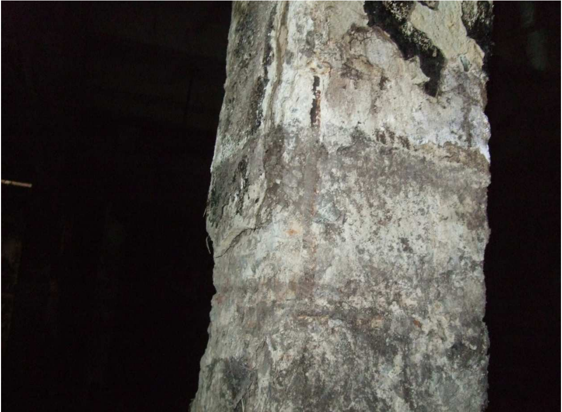
Рисунок 2.9 – Корозія бетону та робочого армування до 18% поперечного перерізу в збірній залізобетонній колоні К«Б-8»
