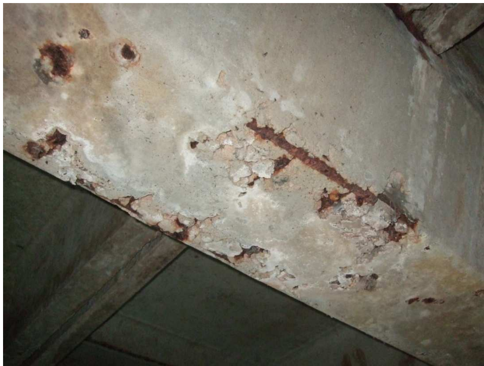
Рисунок 2.8 – Ознаки корозії конструктивного та робочого армування в порах та раковинах, що утворились в результаті недостатнього вібрування бетонної суміші на етапі виготовлення збірному залізобетонного ригеля перекриття
