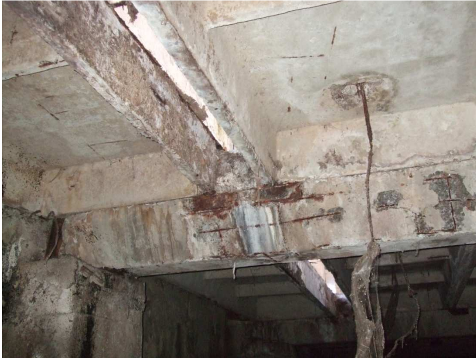
Рисунок 2.7 – Відшарування захисного шару бетону, що супроводжується корозією конструктивного армування в збірному залізобетонному ригелі перекриття в місці отворів для стікання гною
