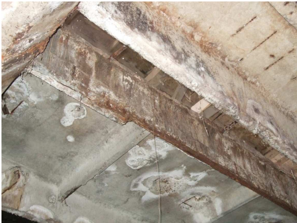
Рисунок 2.10 – Збірна залізобетонна ребриста плита надпідвального перекриття ПЗ2, що містить втрату поперечного перерізу робочого армування до 30%
