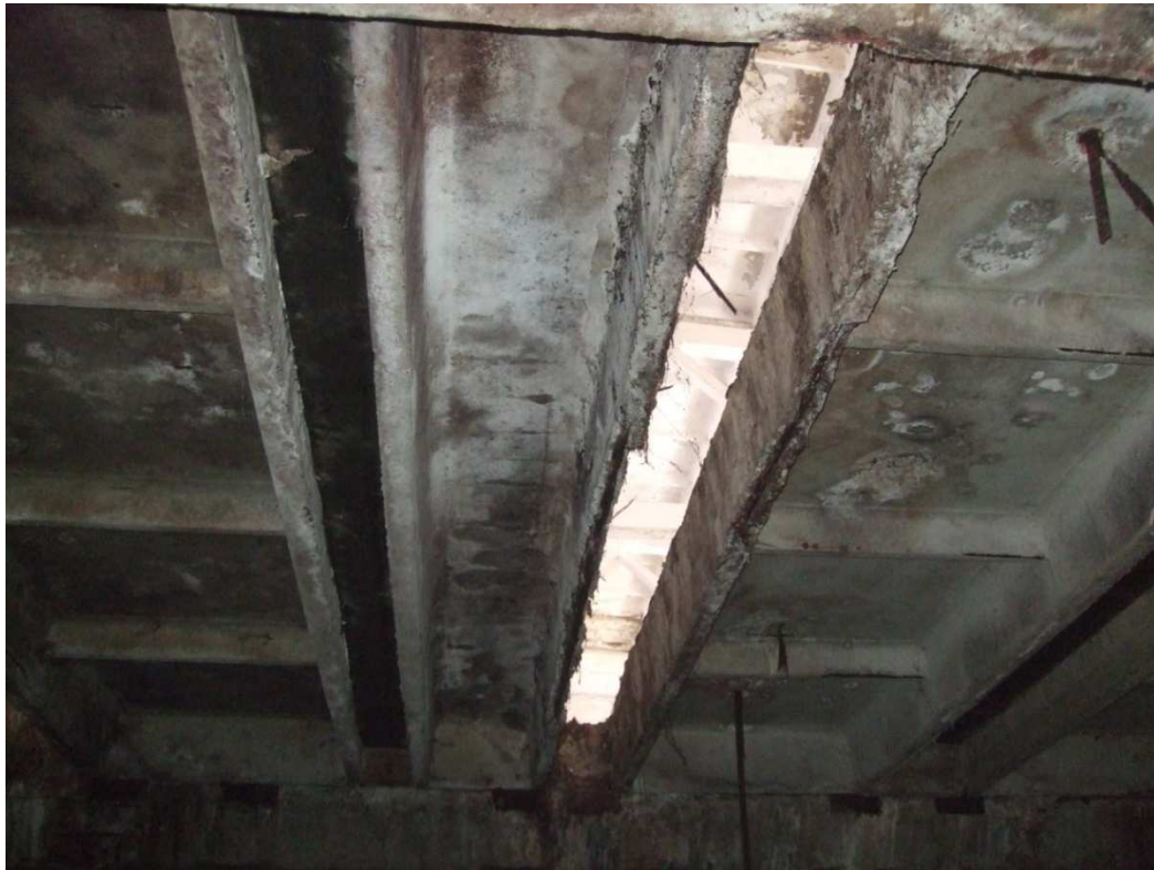
Рисунок 2.11 – Збірна залізобетонна ребриста плита надпідвального перекриття П29, що містить втрату поперечного перерізу робочого армування до 50%
