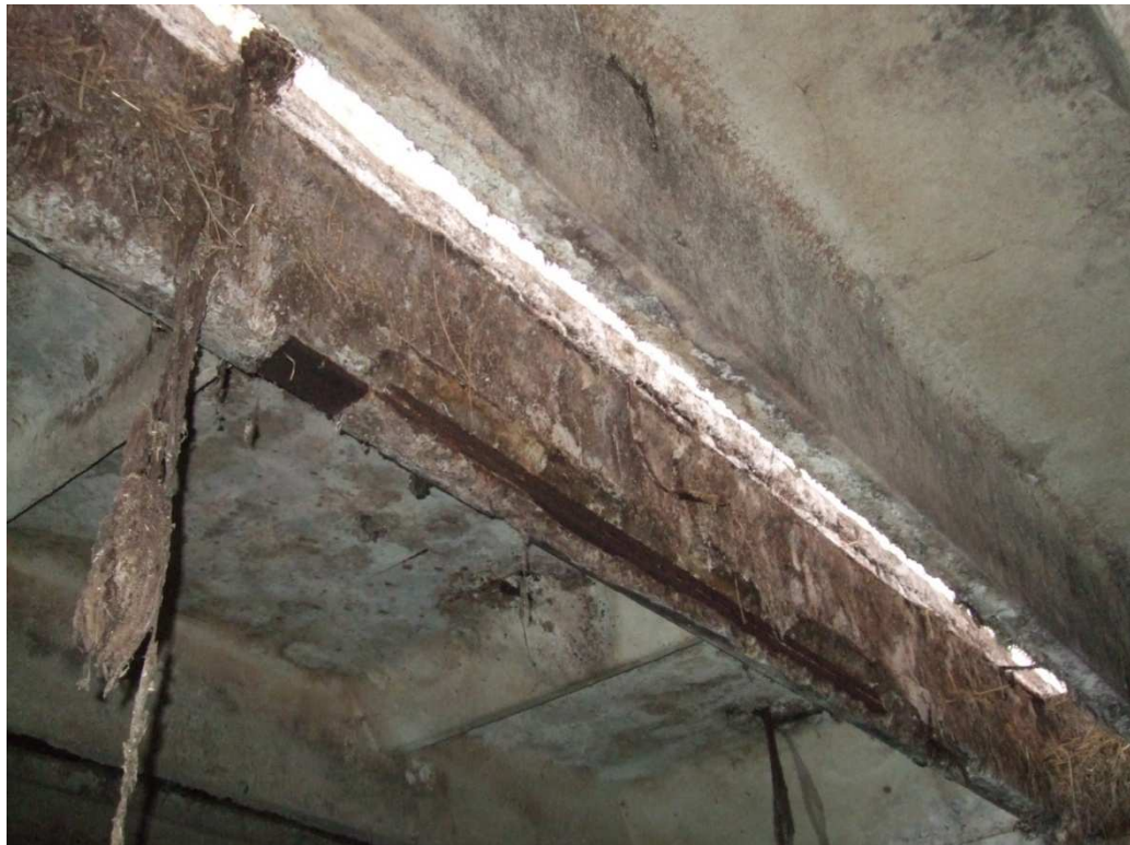
Рисунок 2.12 – Збірна залізобетонна ребриста плита надпідвального перекриття П75, що містить втрату поперечного перерізу робочого армування до 25%
