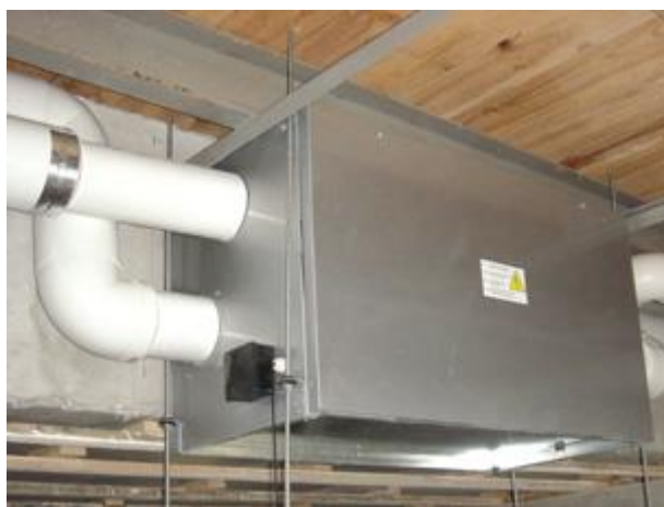
Рисунок 1.1 – Промислова система вентиляції
