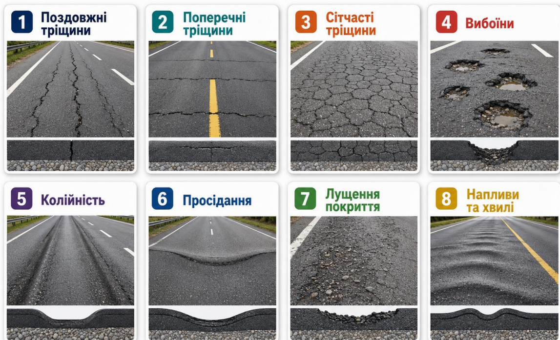
Рисунок 1.2 – Дефекти дорожнього покриття
