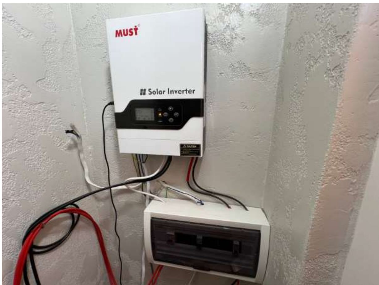
Рисунок 1.1 – Гібридний інвертор Must PV18-24/48V, встановлений у домашній енергетичній системі
