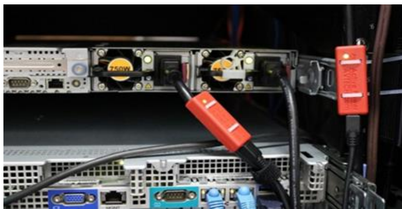
Рисунок 1.3 - Монтаж датчиків промислової системи у серверну стійку
