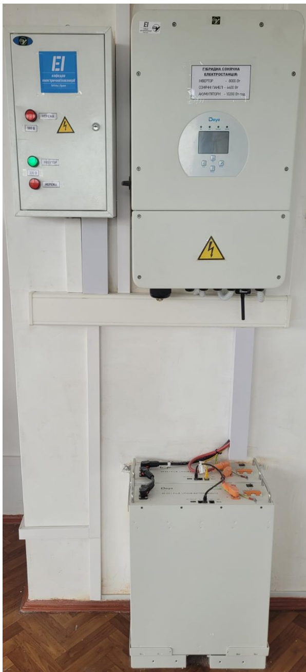
Рисунок 3.1 – Загальний вигляд системи резервного живлення лабораторій кафедри ЕІ ТНТУ на основі фотоелектричної електростанції.
