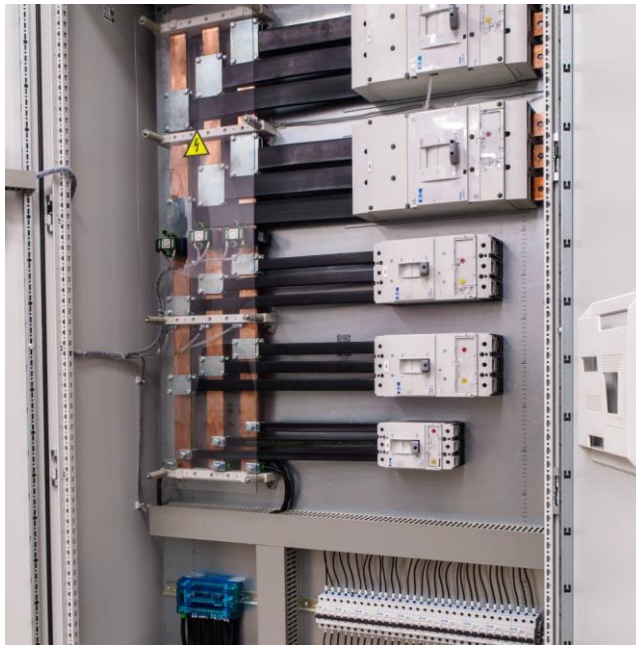
Рисунок 3.3 – Загальний вигляд шафи керування насосами.
