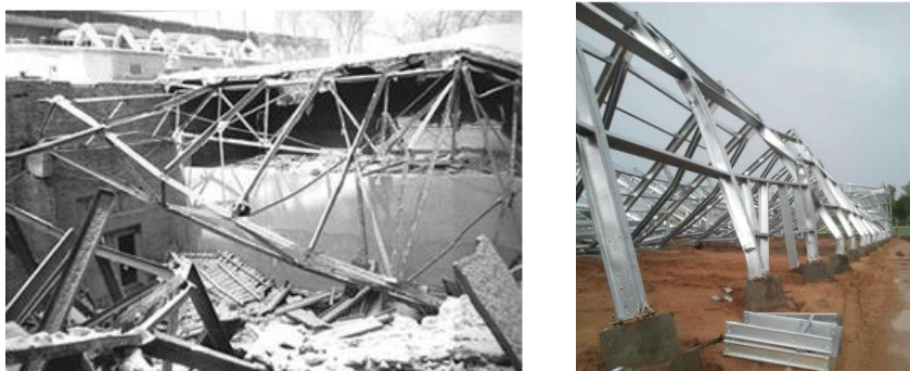
Рисунок 4.1 – Аварії несучих конструкцій
