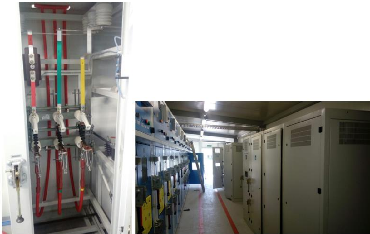
Рисунок 1.5 - Два пристрої КРП на ПС 110/6 кВ.
