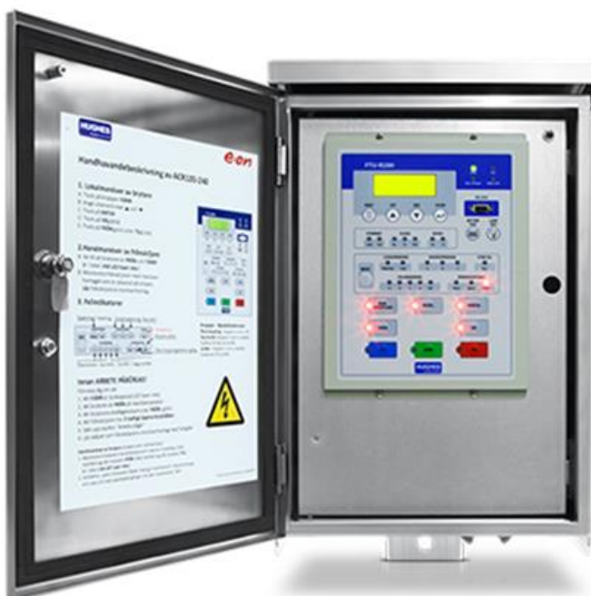
1.3 Релейна шафа, яка встановлюється біля опори і на якій знаходиться реклоузер
