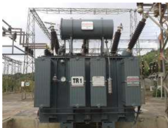
Рисунок 3.11 - Великі трансформатори, встановлені на гідроелектростанціях
