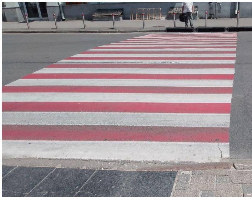
Рис. 1. Неправильно встановлені скоси з бордюрів на пішохідному переході на вул. Сумська
