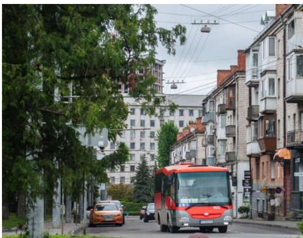
Рисунок 1.4 – Зображення монтажу світлових приладів шляхом підвісу на горизонтальні троси, закріплені на стіни будівель та спеціальні опори на прикладі системи освітлення вул.. Замкова у м. Тернопіль
