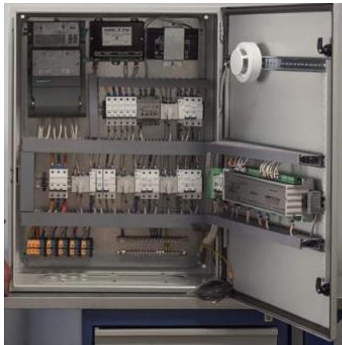
Рисунок 2.5 – Внутрішній монтаж шафа керування зовнішнім освітленням
