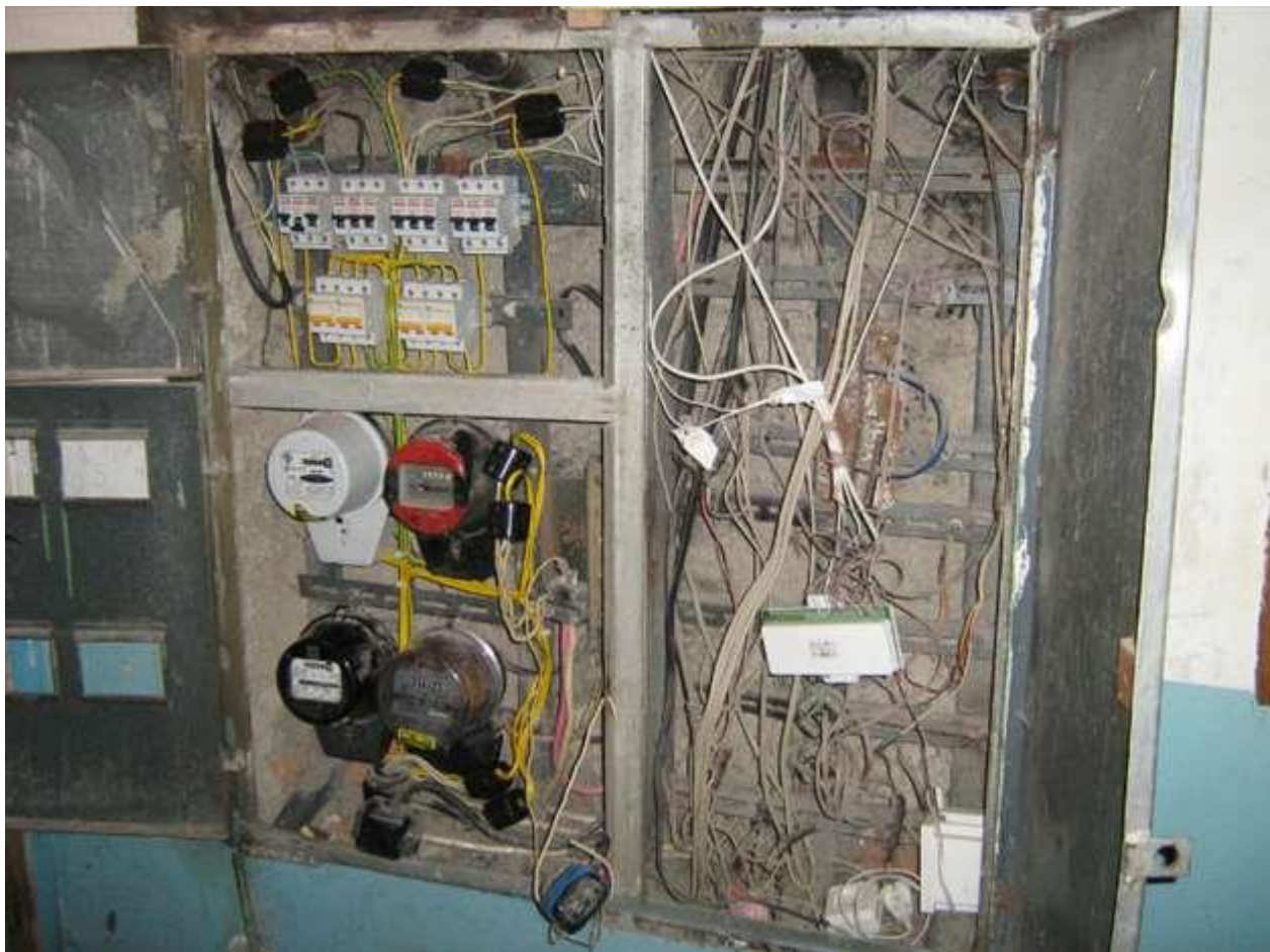
Рисунок 1.6 – Загальний вигляд електрощитової багатоповерхового будинку
