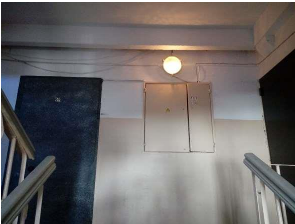
Рисунок 1.2 – Освітлення підїзду лампами освітлення
