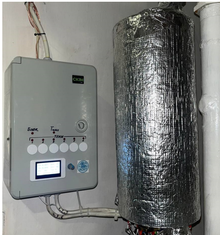
Рисунок 3.4 - Загальний вигляд котла з контролером АСКТ
