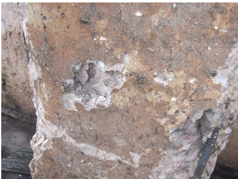
Рисунок 2.11 – Ділянка збірної залізобетонної колони з ознаками корозії бетону в результаті впливу високих температур, що супроводжується його розтріскуванням та відпаданням
