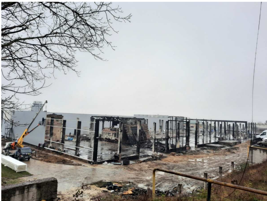
Рисунок 2.4 – Загальний вигляд частини будівлі цеху по виробництву екструдованого пінополістиролу після пожежі
