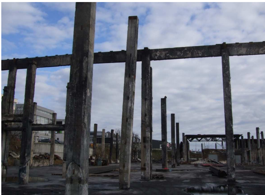
Рисунок 2.8 – Збірна залізобетонна колона середнього ряду КСЗ, що значно відхилилася від вертикалі та потребує демонтажу
