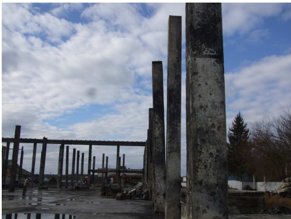
Рисунок 2.7 – Збірна залізобетонна колона крайнього ряду К22, відхилення від вертикалі якої, перевищує допустиму величину
