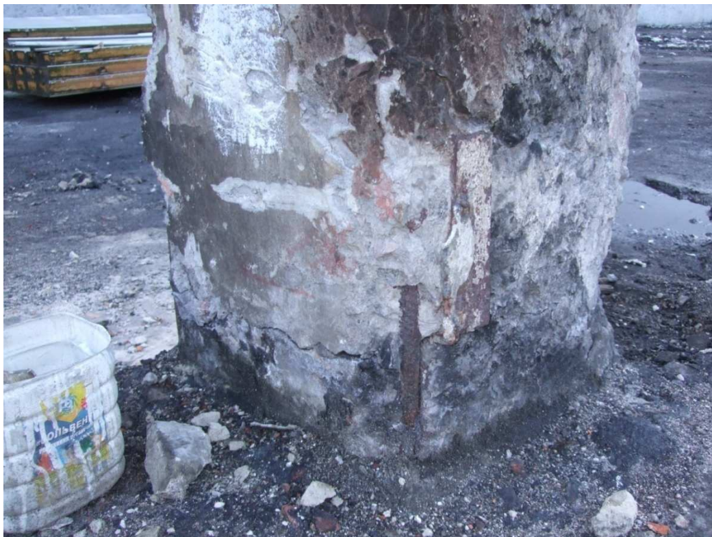
Рисунок 2.9 – Збірна залізобетонна колона середнього ряду КС12, що містить горизонтальну тріщину на глибину до 80% поперечного перерізу
