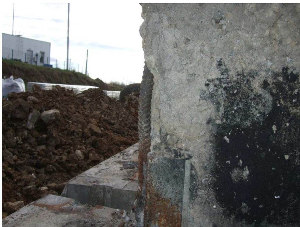
Рисунок 2.13 – Деформування робочої арматури збірної залізобетонної колони крайнього ряду К36 в результаті обгорання
