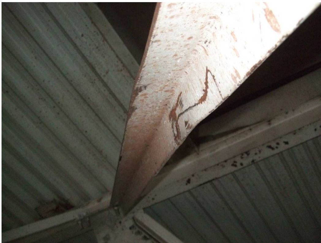
Рисунок 2.6 – Деформація розкошу металевого структурного блоку перекриття будівлі в результаті зовнішніх механічних впливів
