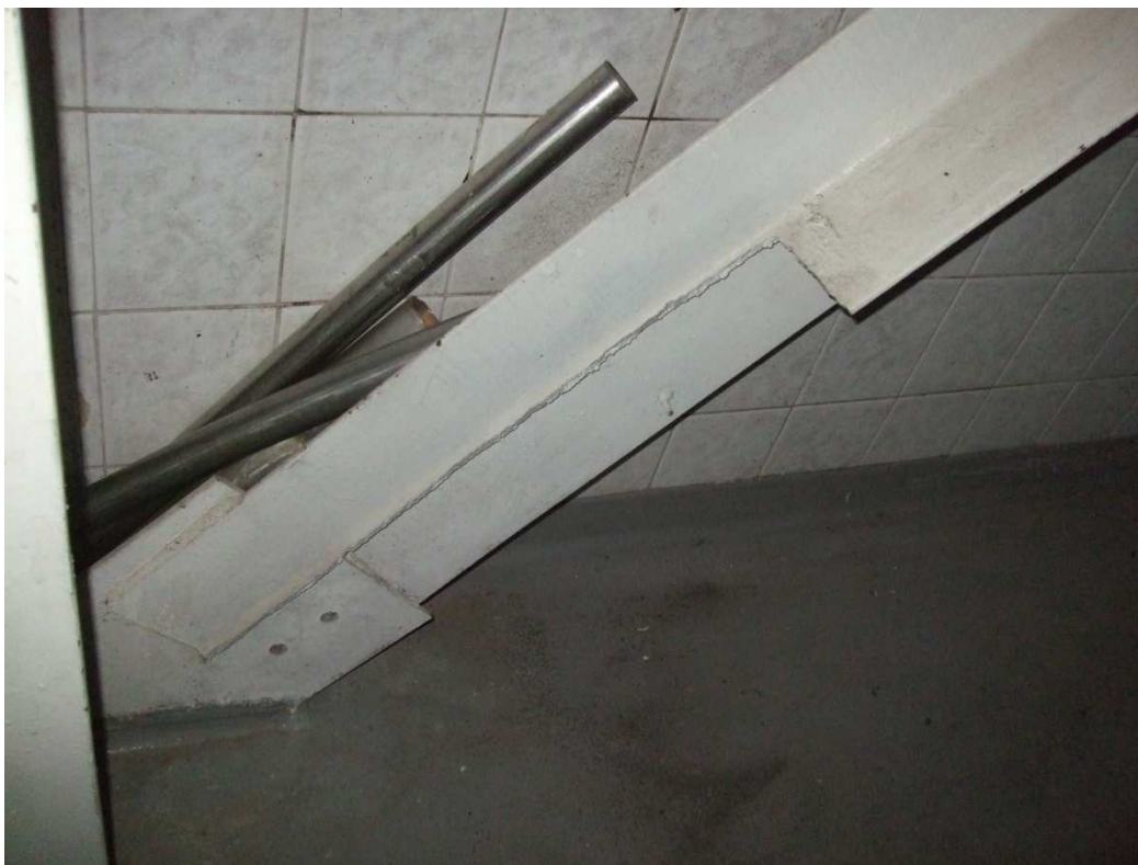
Рисунок 2.12 – Ділянках зменшення поперечного перерізу в результаті механічного пошкодження вертикального зв'язка між колонами
