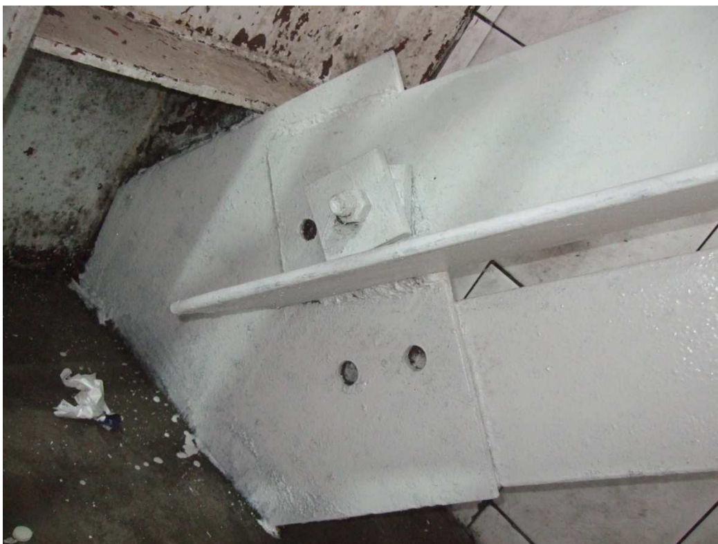
Рисунок 2.11 – Неякісне проварювання зварних швів вертикальних зв'язків між колонами. Відсутність болтових з'єднань
