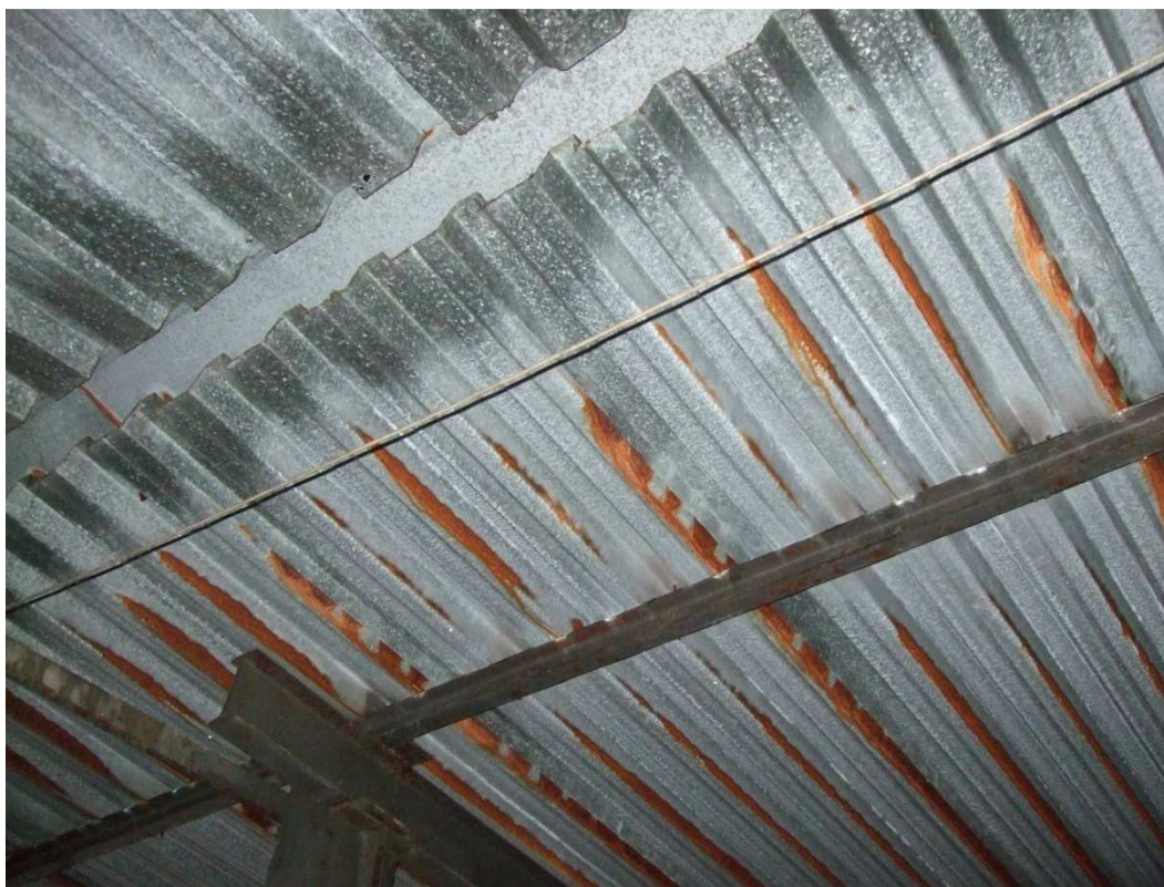
Рисунок 2.7 – Корозія металопрофілю покрівлі будівлі в результаті затікання
