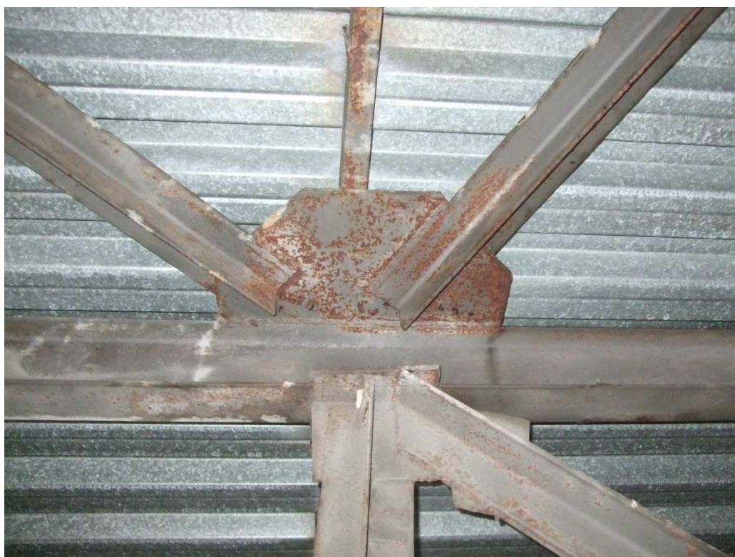
Рисунок 2.5 – Ознаки поверхневої корозії на металевих елементах двоскатного даху будівлі
