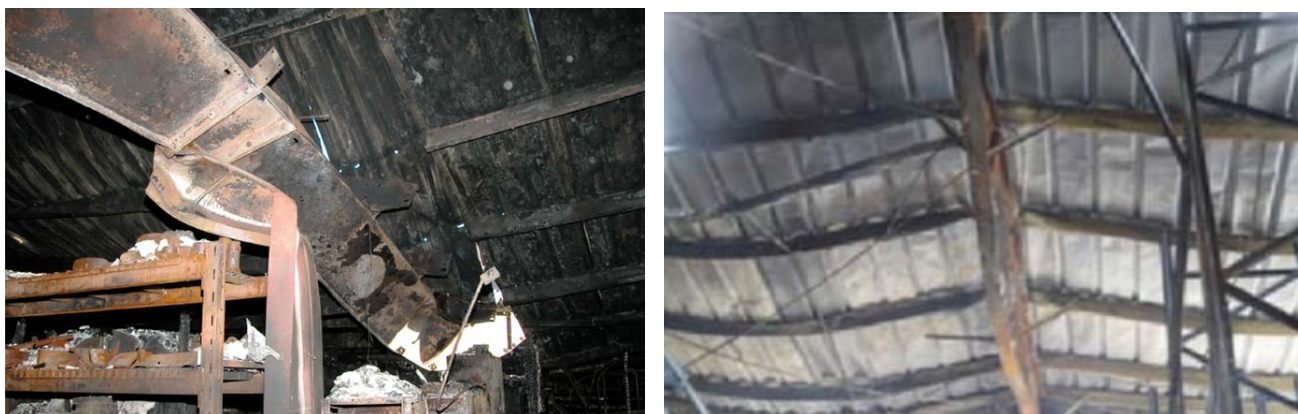
Рисунок 3.1 – Приклади металоконструкцій після впливу пожежі
