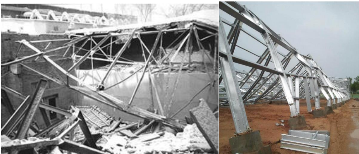
Рисунок 4.1 – Аварії несучих конструкцій
