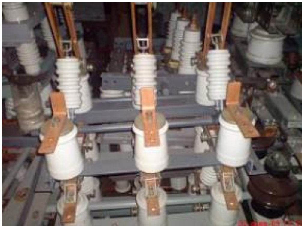
Рисунок 2.10 - Загальний вигляд роз'єднувача зовнішнього встановлення РЛНЗ – 35
