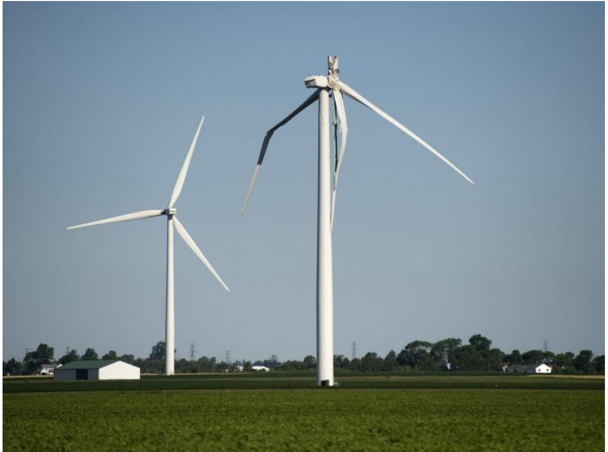
Рисунок 2.9 – Приклад конструкційної несправності наземних вітрових турбін
