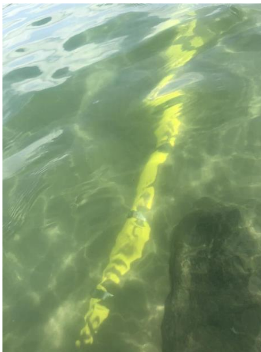
Рисунки 3.7 – Оголений кабель вітроелектростанції Блок-Айленд, США
