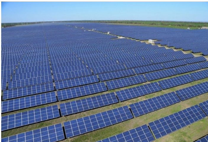
Рисунок 1 – Сонячна електростанція Старокозаче
