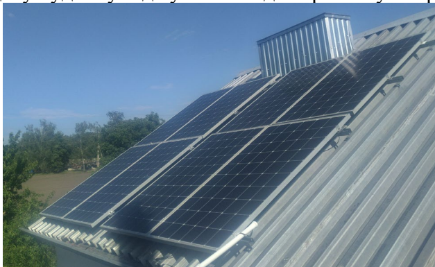
Рисунок 1 – Фотоелектричні панелі на даху будинку
