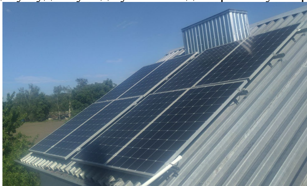
Рисунок 1 – Фотоелектричні панелі на даху будинку
