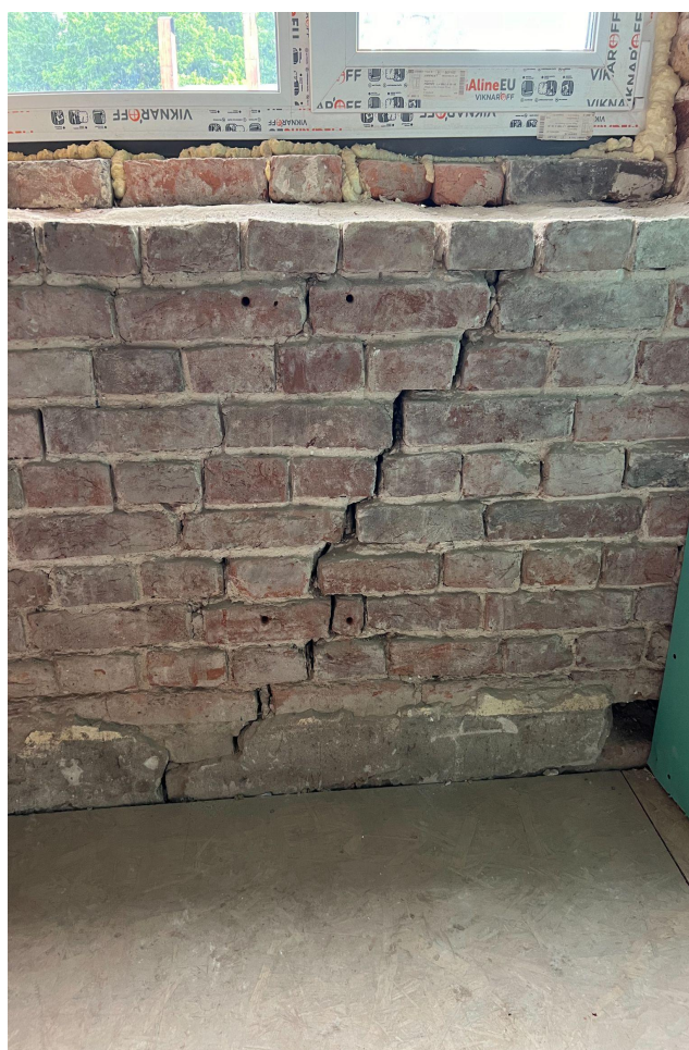
Рисунок 2.7 - Фото тріщини, взятої для дослідження
