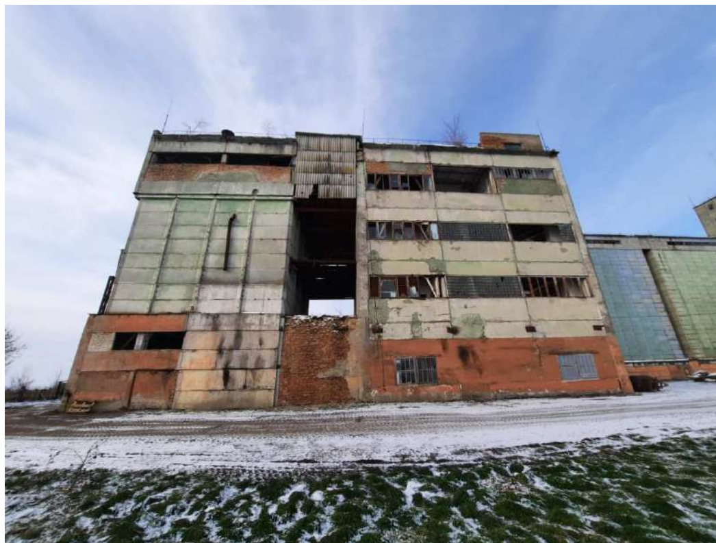
Рисунок 3.1 – Загальний вигляд будівлі Круп'яного цеху під літ. «К», що знаходиться за адресою вул. Котляревського, 8 у м. Волочиськ Хмельницької області
