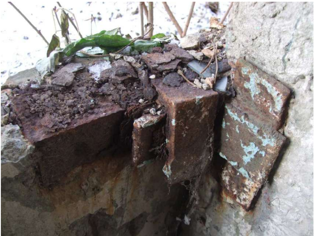
Рисунок 3.9 – Стан закладних деталей кріплення стінового огороження до каркасу будівлі
