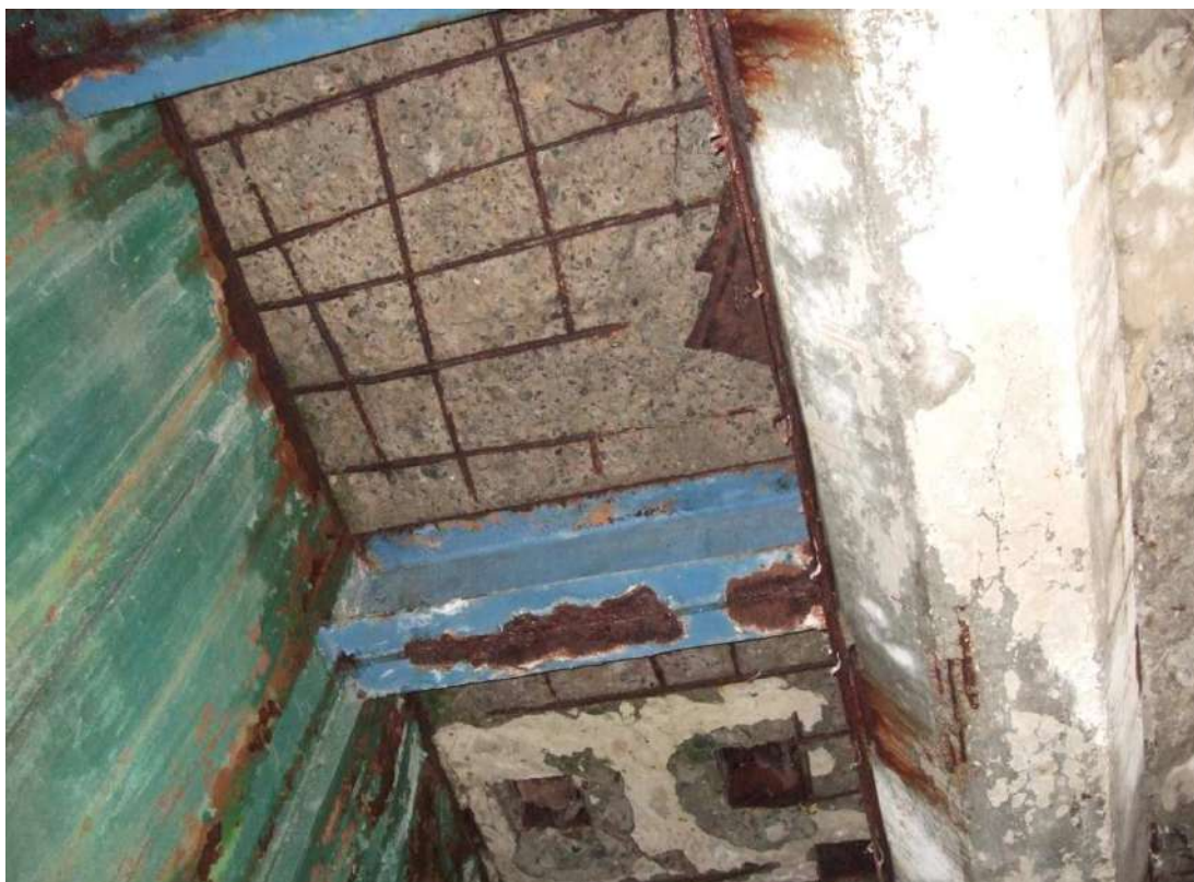
Рисунок 3.10 – Стан монолітних залізобетонних перекриттів 2-го поверху в осях «А-Г» та «8-9», 3-го поверху в осях «А-Г» та «8-9»
