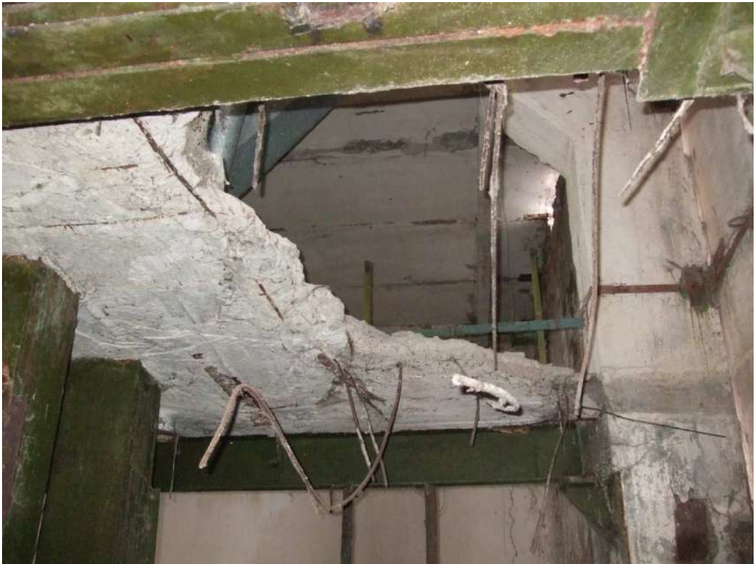
Рисунок 3.8 – Ділянка руйнування монолітного залізобетонного перекриття 1-го поверху в осях «Б-Е» та «1-6», що армоване арматурою гладкого профілю
