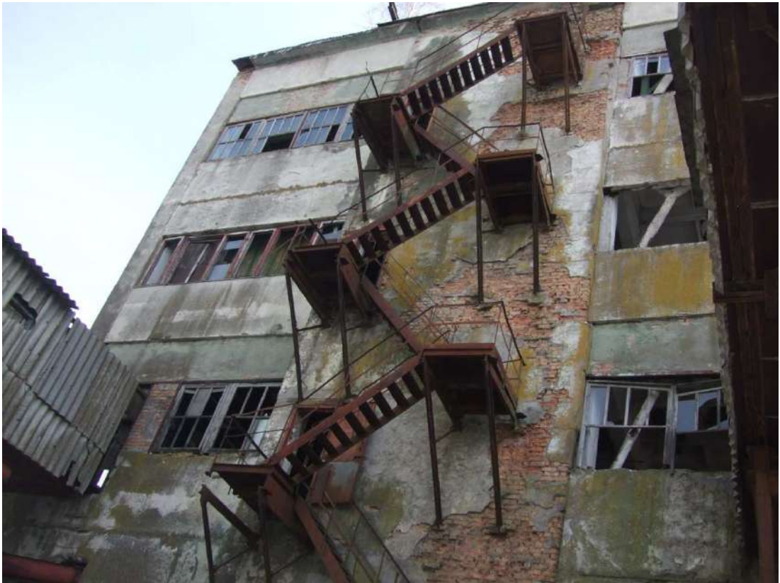
Рисунок 3.6 – Сходи зовнішні пожежні між осями «7-8», що кріпляться до аварійної цегляної стіни огороження та підлягають демонтажу
