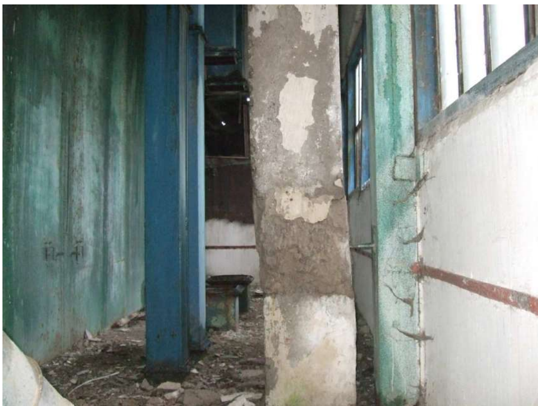
Рисунок 3.11 – Відхилення від вертикалі колони 3-го поверху в результаті неправильного монтажу
