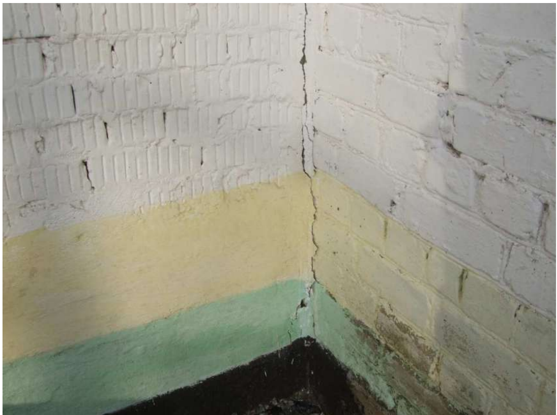
Рисунок 3.17 – Тріщина в зоні блокування прибудови до будівлі пресового відділення. Відсутність штукатурного покриття зовнішньої поверхні стін
