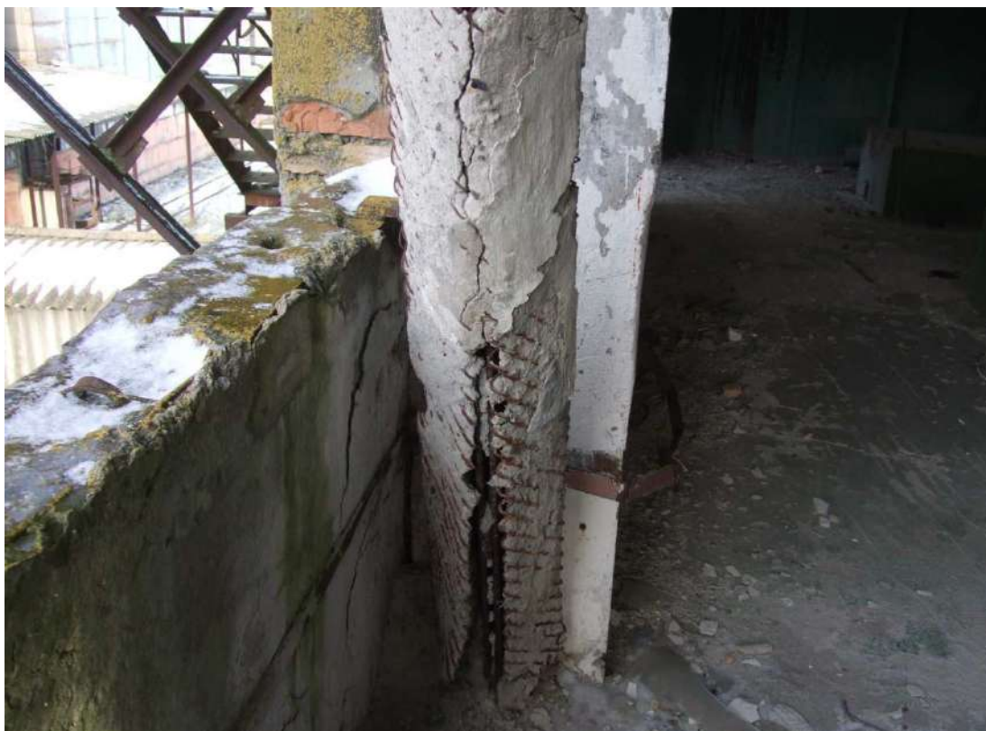
Рисунок 3.14 – Стан захисного покриття металевих порталних в'язей
