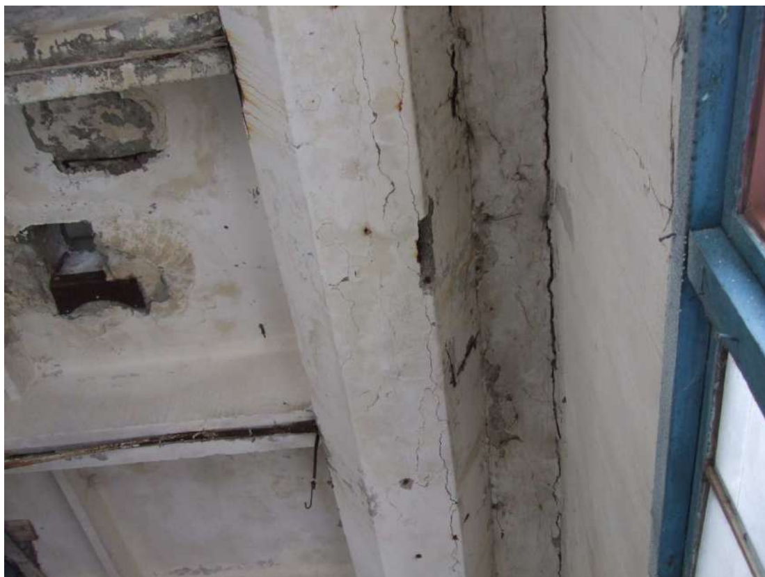
Рисунок 3.13 – Збірний залізобетонний ригель перекриття 3-го поверху, що потребує підсилення
