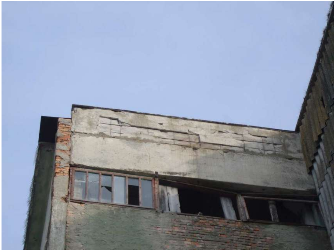
Рисунок 3.7 – Аварійний стан парпетної збірної залізобетонної стінової панелі
