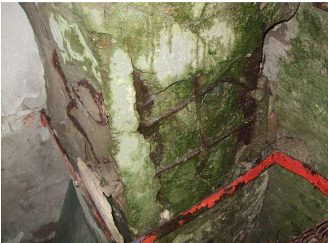
Рисунок Д.3.12 – Стан монтажних стиків колон 3-го та 4-го поверху будівлі в результаті систематичного замокання
