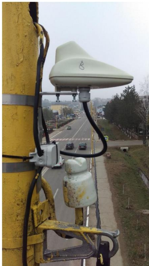
Рисунок 3.10. Контролер вуличного освітлення FRE-220 на центральній вулиці м. Борщова
