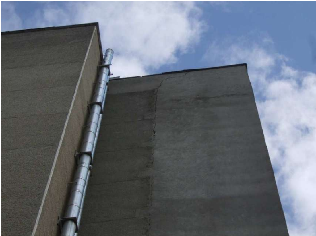
Рисунок 3.4 – Тріщина на всю висоту прибудованої незадимлюваної сходової клітки в зоні примикання до будівлі готелю
