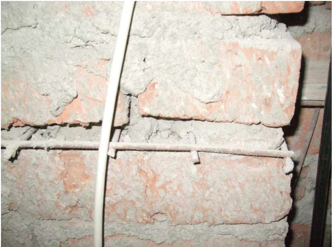
Рисунок 3.16 – Ділянка «Ст-4» дослідження цегляної кладки несучої стіни 6-го поверху будівлі готелю. Виступаюча частина сітки армування кладки з дроту Вр-I Ø5 мм
