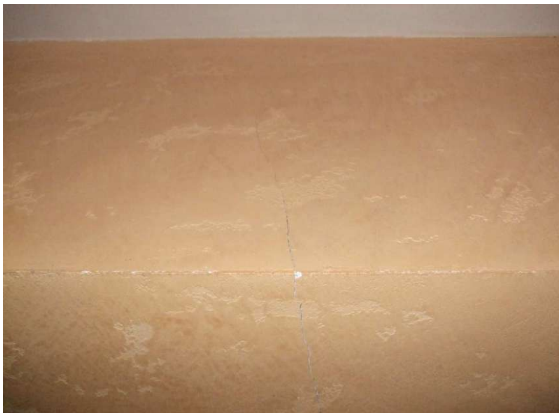
Рисунок 3.11 – Нормальна тріщина в монолітній залізобетонній балці БМ-4 з шириною розкриття тріщини до 0,4 мм
