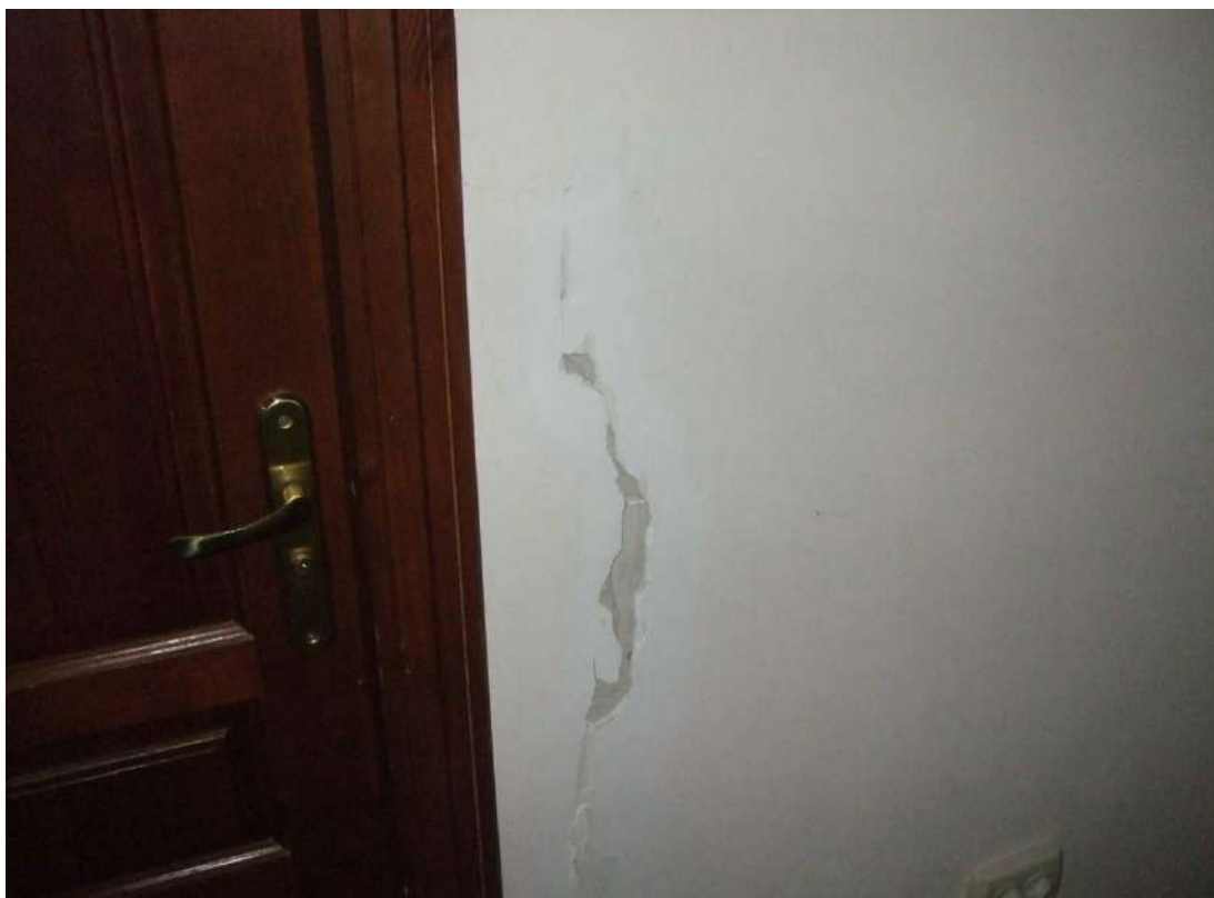
Рисунок 3.13 – Ділянка відшарування опорядження стін коридору будівлі готелю
