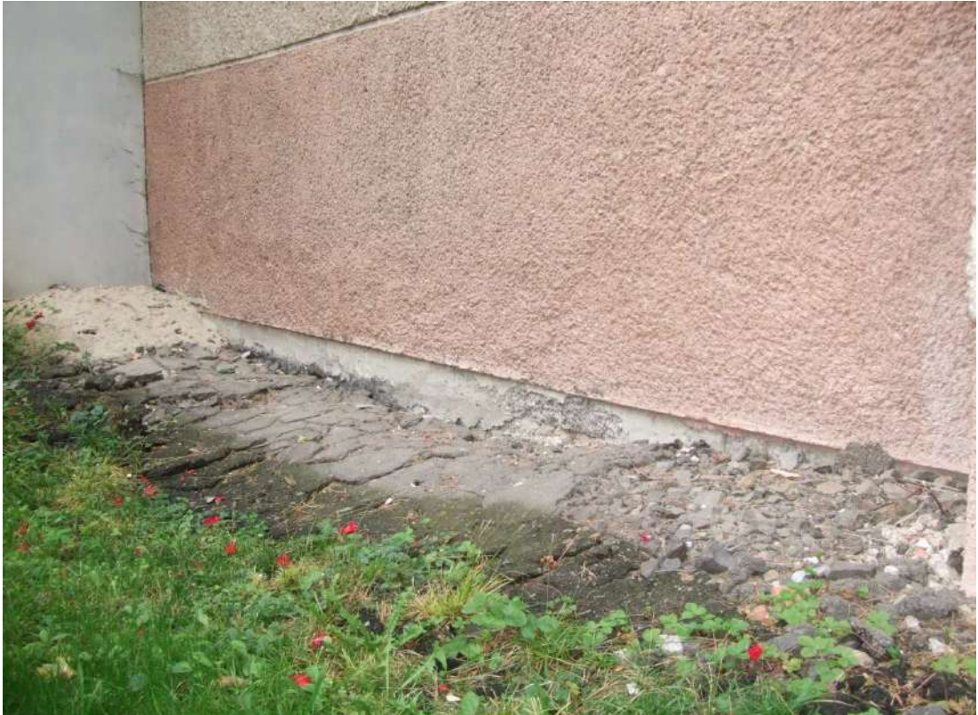
Рисунок 3.7 – Ділянка з просіданням асфальтобетонної відмостки будівлі готелю до 30 см
