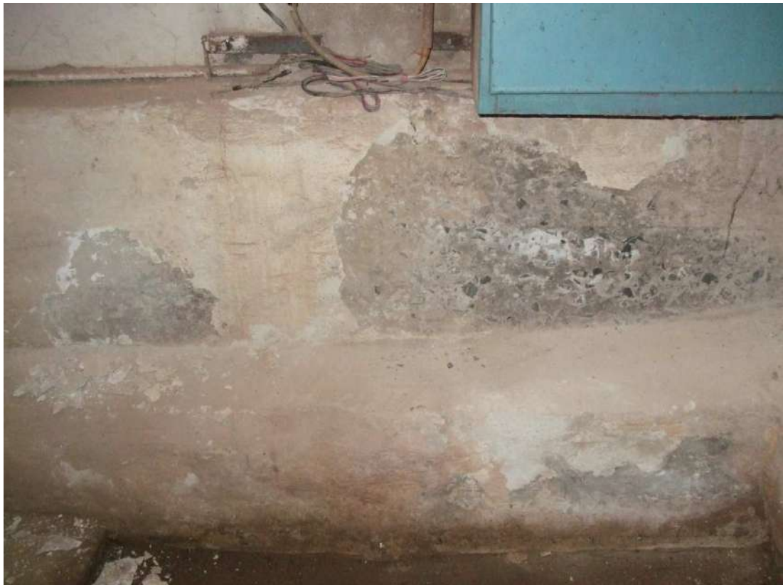
Рисунок 3.10 – Ділянка з ознаками корозії бетону збірних бетонних блоків стін техпідвалу одноповерхової прибудови рецепції
