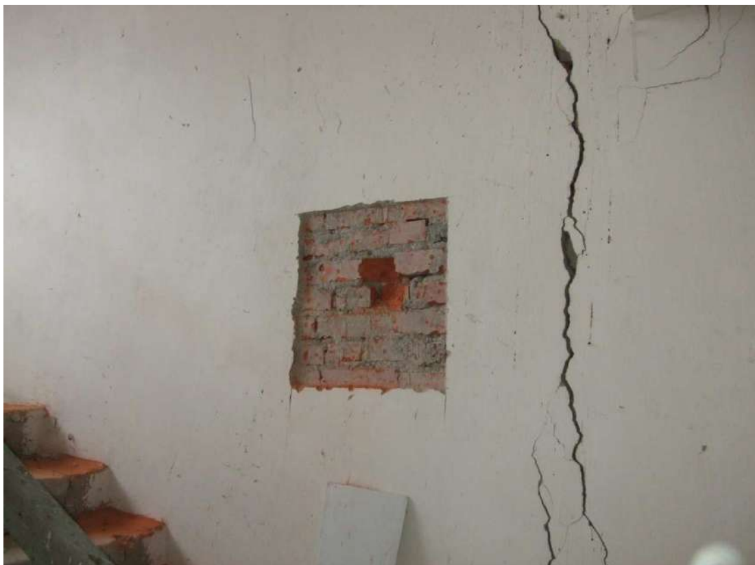
Рисунок 3.18 – Ділянка «Ст-9» дослідження цегляної кладки несучої стіни. Місце відбору зразків розчину. Наскрізна тріщина шириною розкриття 12,0 мм в несучій стіні 12-го поверху незадимлюваної сходової клітки
