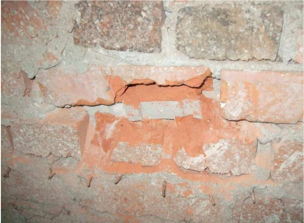
Рисунок 3.15 – Ділянка «Ст-1» дослідження цегляної кладки несучої стіни 1-го поверху будівлі готелю. Місце відбору зразків розчину. Виступаюча частина сітки армування кладки з дроту Вр-I Ø3,5 мм
