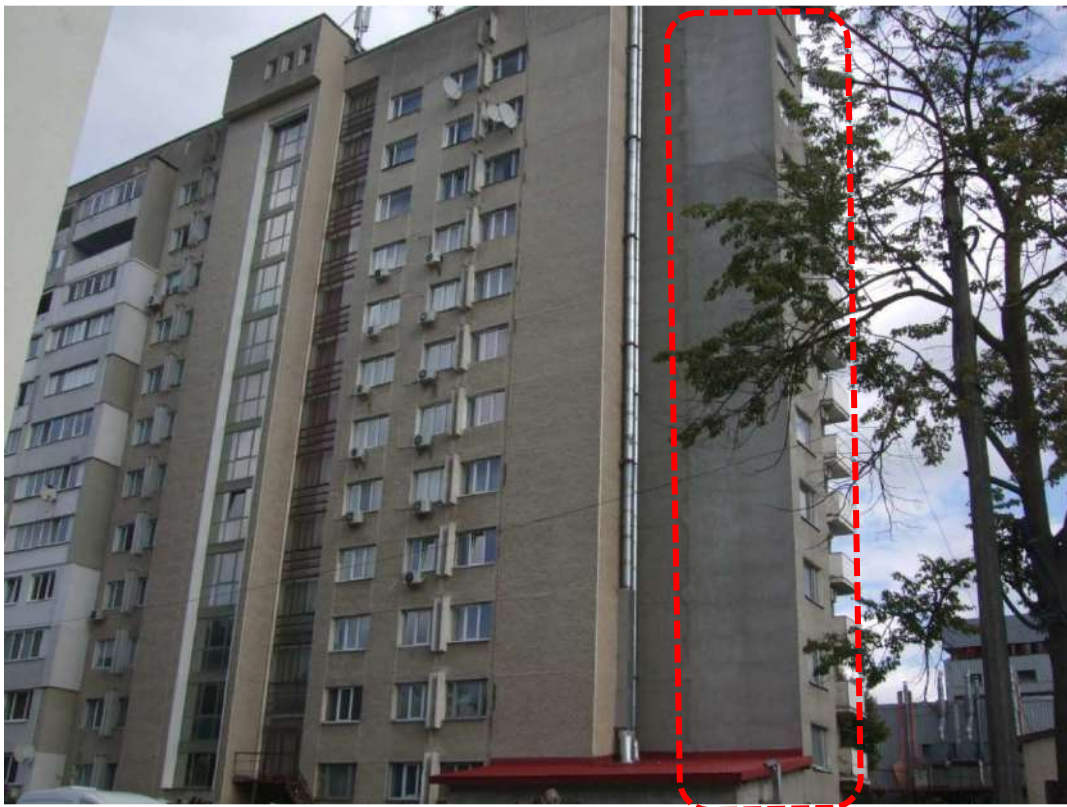
Рисунок 3.2 – Загальний вигляд прибудованої до будівлі готелю незадимлюваної сходової клітки (виділено штриховою лінією)
