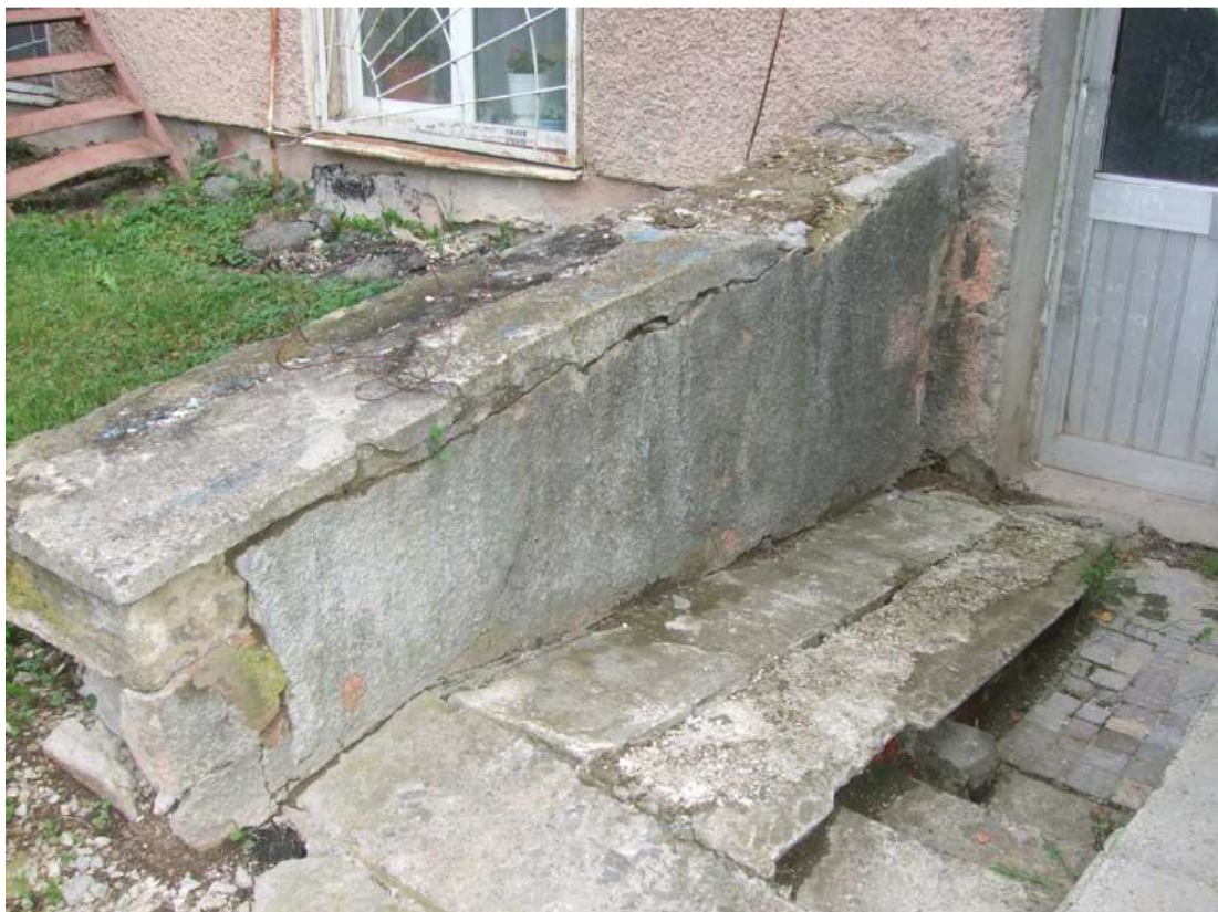
Рисунок 3.8 – Стан опорядження сходів одного із виходів з будівлі готелю
