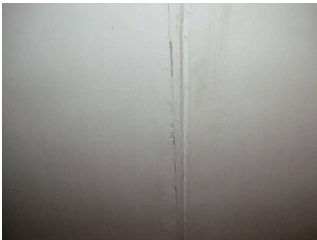
Рисунок 3.12 – Волосяні тріщини в зоні примикання збірних залізобетонних плит міжповерхових перекриттів між собою
