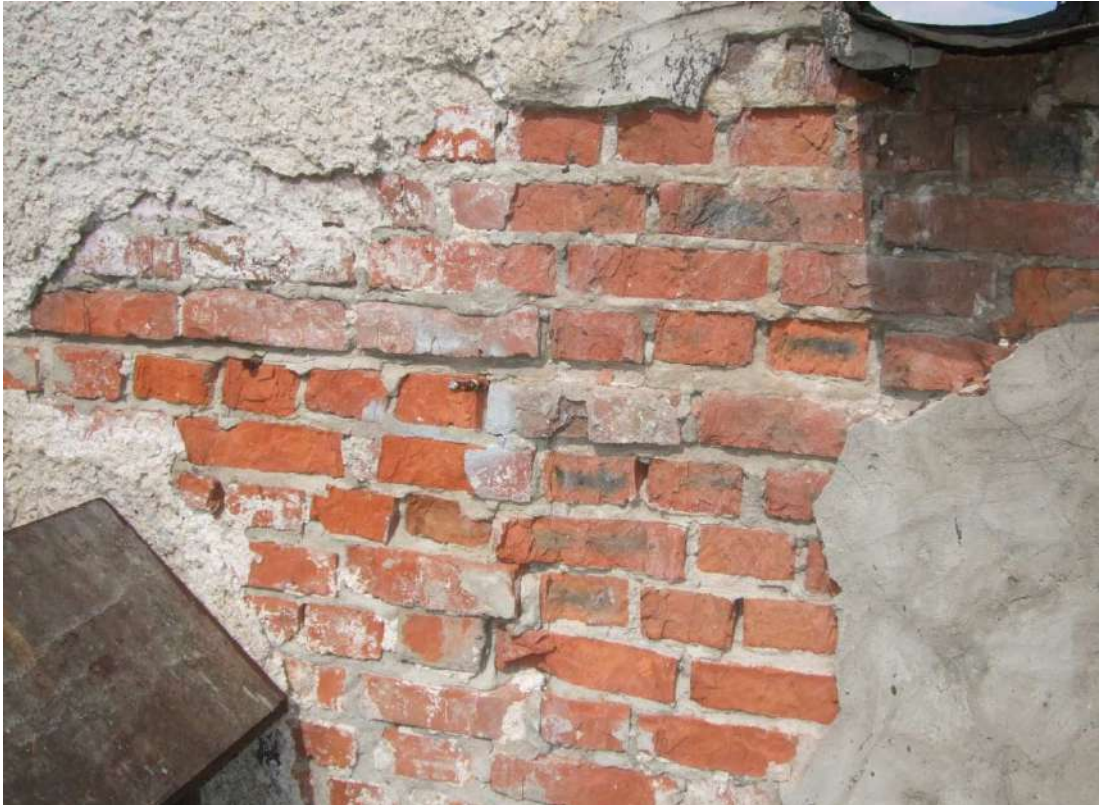
Рисунок 3.9 – Відшарування цементно-піщаної штукатурки та руйнування окремих ділянок верхніх шарів цегляної кладки стін парпету будівлі готелю
