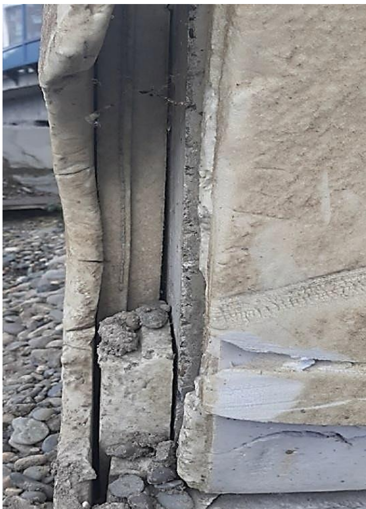
Рисунок 1.7 - Приклад порушення технології кріплення шару утеплювача до несучого шару стіни цоколя в будівлі
