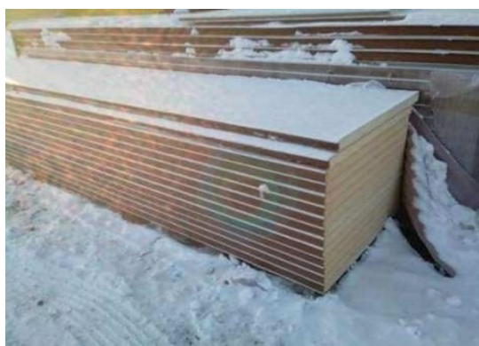
Рисунок 1.22 - Порушення складування сендвіч-панелей при атмосферних опадах (сніг)
