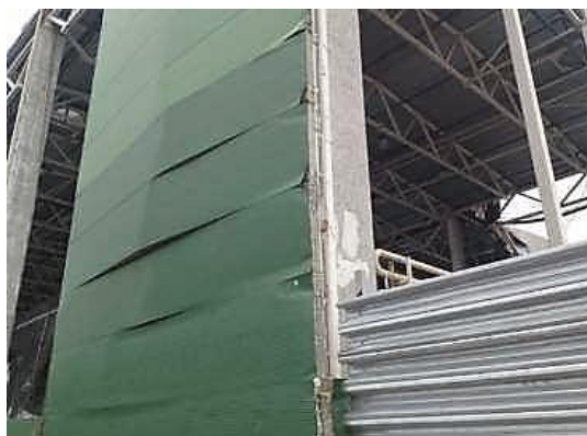
Рисунок 1.17 - Зминання сендвіч-панелей на опорах
