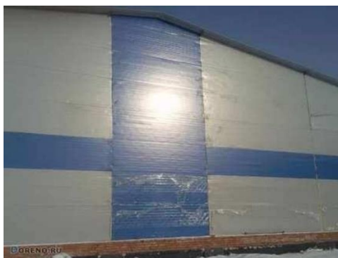
Рисунок 1.20 - Зминання сендвіч-панелей на опорах через перетягнуті саморізи
