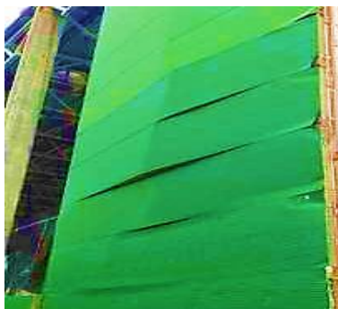
б) зминання сендвіч-панелей на опорах
