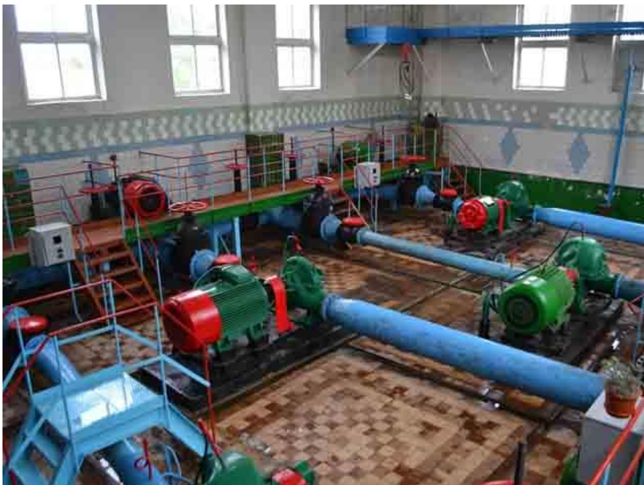
Рисунок 1.3 – Загальний вигляд машинного відділення свердловини Північного водозабору.
