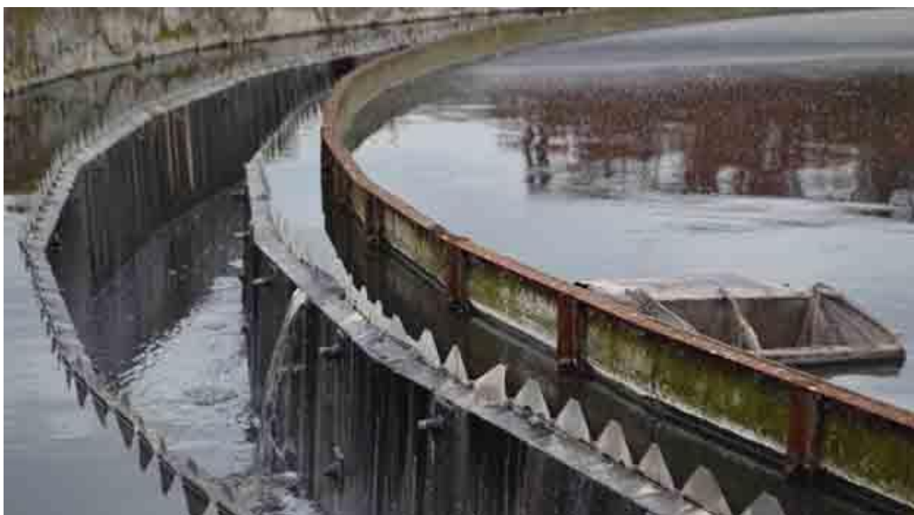
Рисунок 1.5 – Очисні споруди КП «Новоовлинськводоканал».
