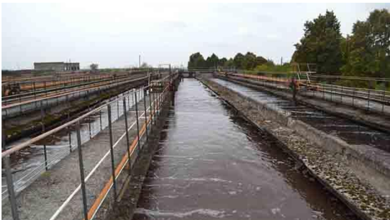
Рисунок 1.6 – Очисні споруди КП «Новоовлинськводоканал».
