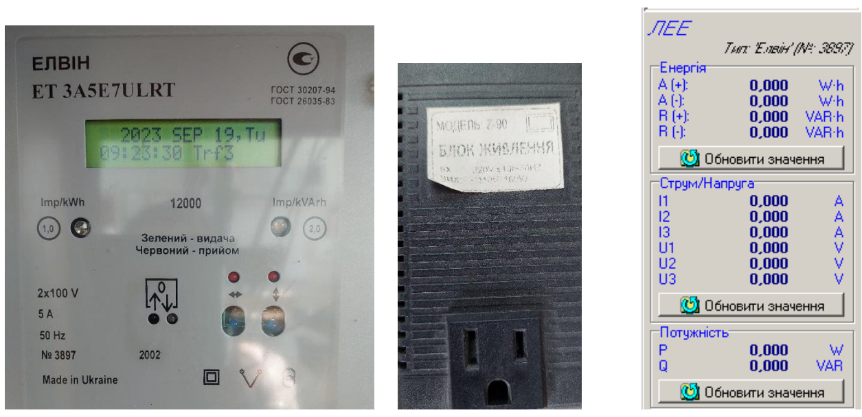
Рисунок 10 – Лічильник електроенергії з блоком живлення і програмне вікно контролю показників
