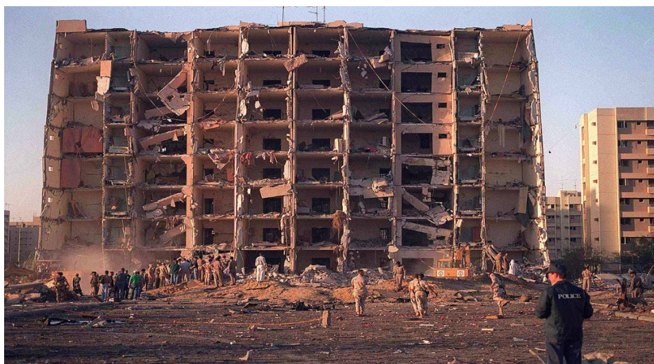
Рисунок 1.4 – Наслідки вибуху та прогресуючого руйнування будівлі внаслідок пошкодження несучих конструкцій, м. Ель-Хубар, 1996 р. [13]
