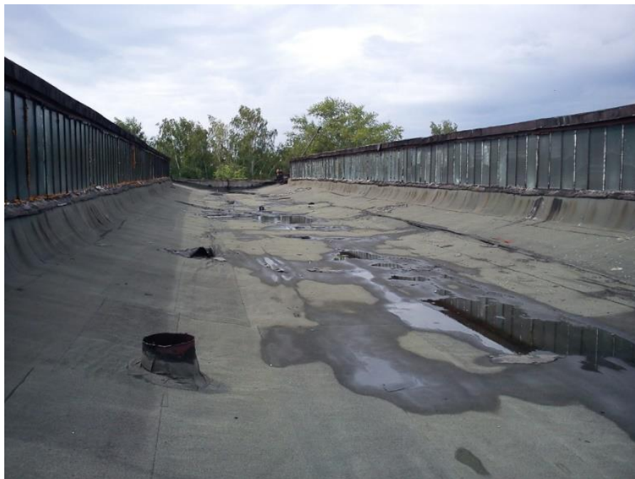
Рисунок 3.4 - Місцеве пошкодження гідроізоляційного матеріалу покрівлі промислової будівлі
