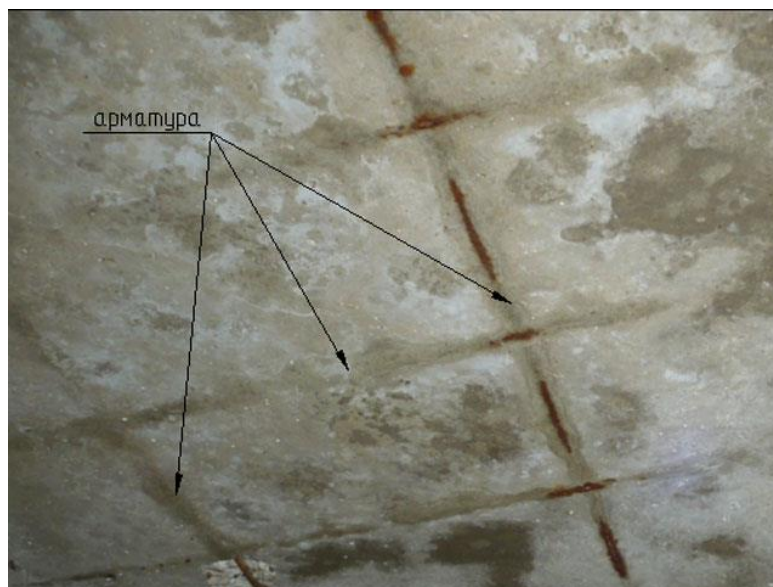
Рисунок 3.8- Порухнення захисного шару бетону у арматури
