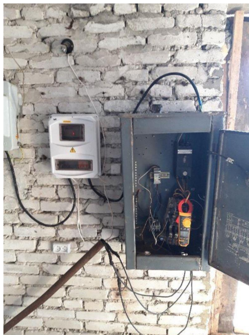
Рисунок 2.28 – Проведення вимірювань приладом FLUKE 319 струмових навантажень у фазних проводах насоса «Глибинний верх №2»
