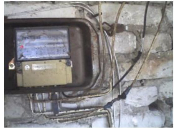
б) лічильник ел.енергії
