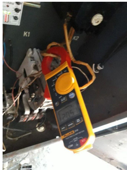
Рисунок 2.30 – Проведення вимірювань приладом FLUKE 319 струмових навантажень у фазному проводі L3 насоса «Глибинний вверх №2»
