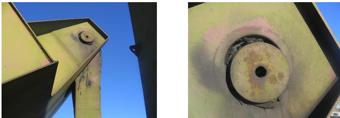
Рис. 6. Знос шарнірного з'єднання елементів металоконструкції стрілової системи в наслідок порушення регламенту технічного обслуговування та ремонту крану
