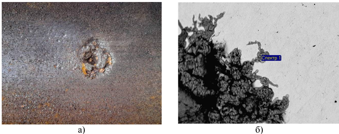
Рис.1. Поверхня внутрішньої ділянки труби з наскрізним локальним руйнуванням (а) та її поперечного перерізу (б).
