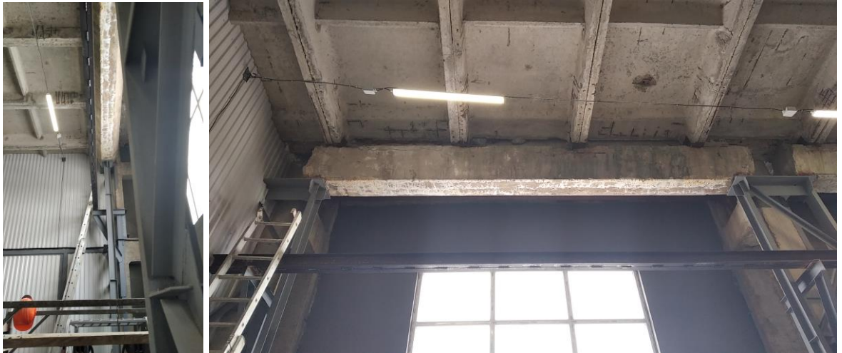
Рисунок 1.6 – Залізобетонна балка довжиною 6 метрів яка потребує зміцнення
