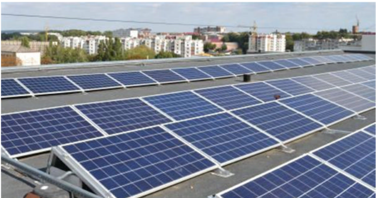
Рисунок 4.1 – Сонячні панелі на даху корпусу №4 ХНУ
