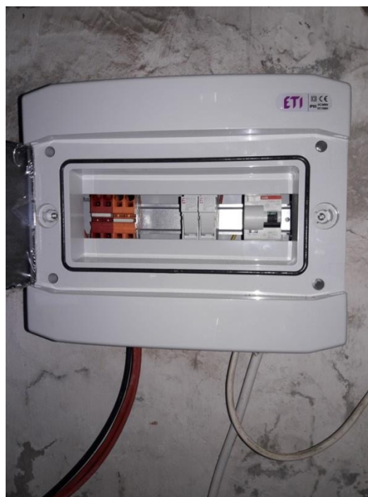
Рисунок 3.8 – Вхідний силовий щиток
