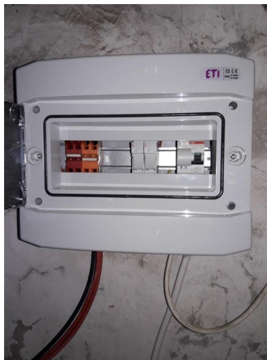
Рисунок 3.8 – Вхідний силовий щиток
