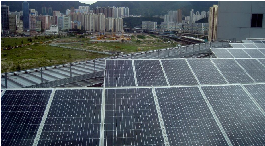
Рис. 1.3 Сонячна дахова електростанція
