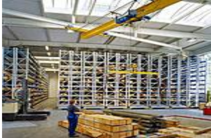
Рисунок 2.8 – Загальний вигляд мостового крана вантажопідйомністю Q = 5 тон
