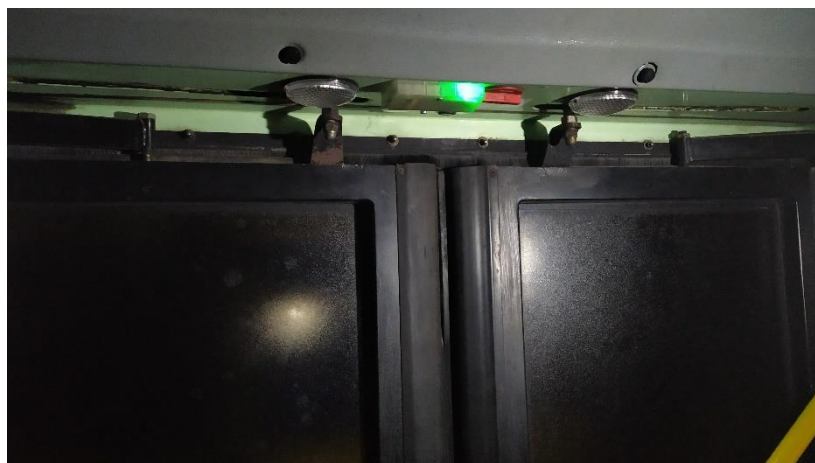
Рисунок 3.3 – Вигляд встановленого над дверима контролера
