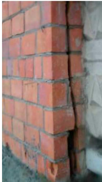
Рисунок 5.1 – Приклад руйнування цегляної кладки
