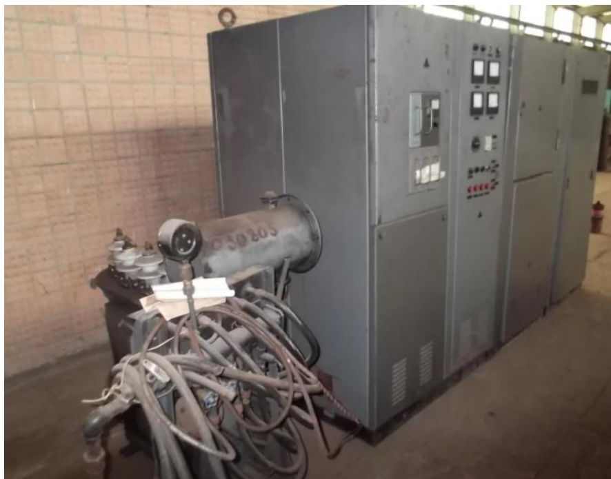
Рисунок 3.2 - Загальний вигляд високочастотного генератора ВЧГ9- 60 / 0,44
